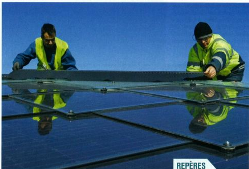
Pose de tuiles photovoltaïques sur les toits des entrepôts de fruits et légumes du marché Saint-Charles à Perpignan.
